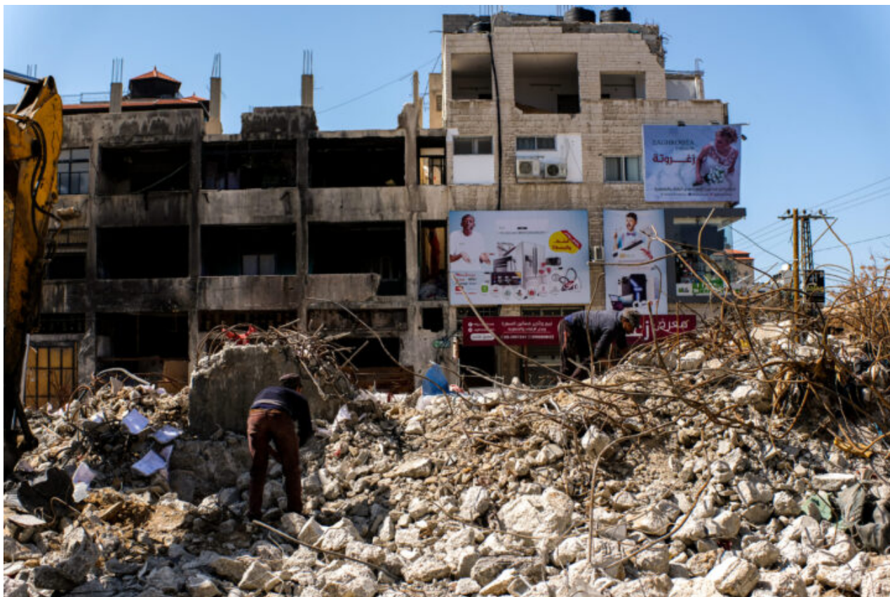
I lavoratori rimuovono le macerie della torre al-Shorouq ad al-Rimal, distrutta durante l'ultima offensiva israeliana a Gaza nel maggio del 2021.
