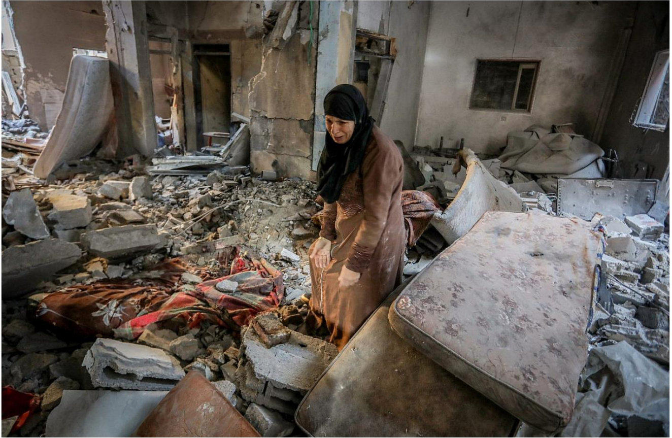
Palestinesi ispezionano la loro casa distrutta dopo un attacco aereo israeliano a Rafah, nel sud della Striscia di Gaza, l'8 febbraio 2024. (Abed Rahim Khatib/Flash90)
